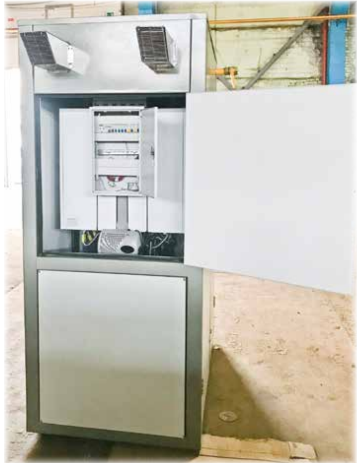
Доступ к электрическому щиту
